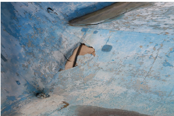
Hier ist nichts mehr zu reparieren: Das obere Becken kann nur noch abgerissen werden. Foto: Michael Wirkner
