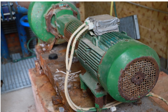
Die in die Jahre gekommene Technik kann nur in ihrer Gesamtheit ausgetauscht werden. Noch hat sie Bestandsschutz. Foto: Michael Wirkner
