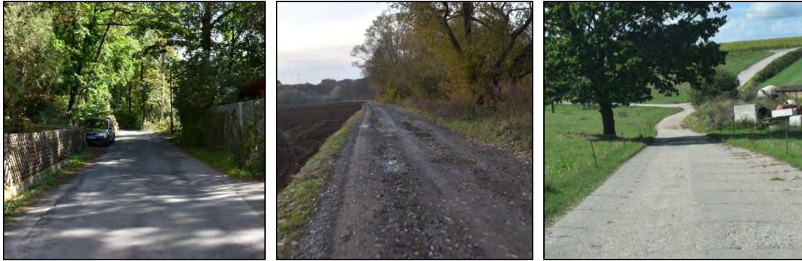
Abb. 5 Fahrbahnoberflächendefizite auf wichtigen interkommunalen Verbindungen
