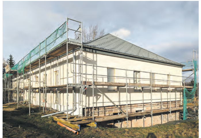
In Dittrichshütte wird ein Neubau für den Kindergarten errichtet. Das um 1958 eingeschossig errichtete Gebäude, dessen Bauzustand modernisierungsbedürftig war, wird energetisch saniert, die Innenräume für eine zeitgemäße Nutzung modernisiert sowie die Außenanlagen umgestaltet.
