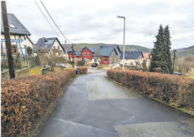
In Birkenheide wurde innerörtlich die Straße abschnittsweise instand gesetzt und die Straßenbeleuchtung erneuert.
