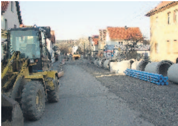
Der ZWA führt seit Mitte Februar seine Baumaßnahmen in der Cumbacher Straße weiter. Die Straße ist wieder abschnittsweise voll gesperrt. Der Durchgangsverkehr und die Buslinie wird über die Straße Am Gänsebach umgeleitet. (Foto: F.M. Wagner)
